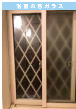
浴室の窓ガラス
